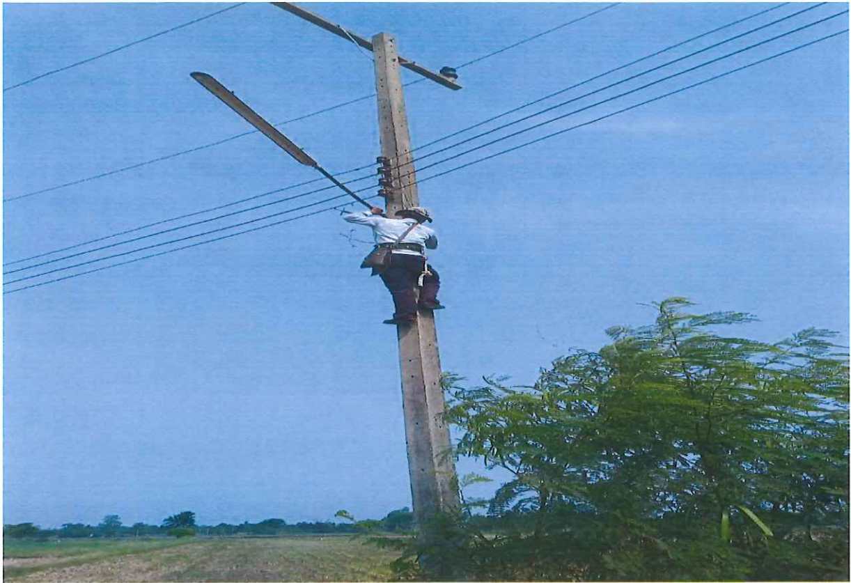
ภาพถ่ายขณะดำเนินการแก้ไขปัญหาความเดือดร้อน ซ่อมแซมไฟฟ้าสาธารณะ บริเวณหน้าบ้าน นางหนูเพียร โกฏีรักษ์ ประชาชน บ้านขมื่น หมู่ที่ 5 ตำบลนาดี อำเภอยางตลาด จังหวัดกาฬสินธุ์ ในวันที่ 7 พฤษภาคม 63
