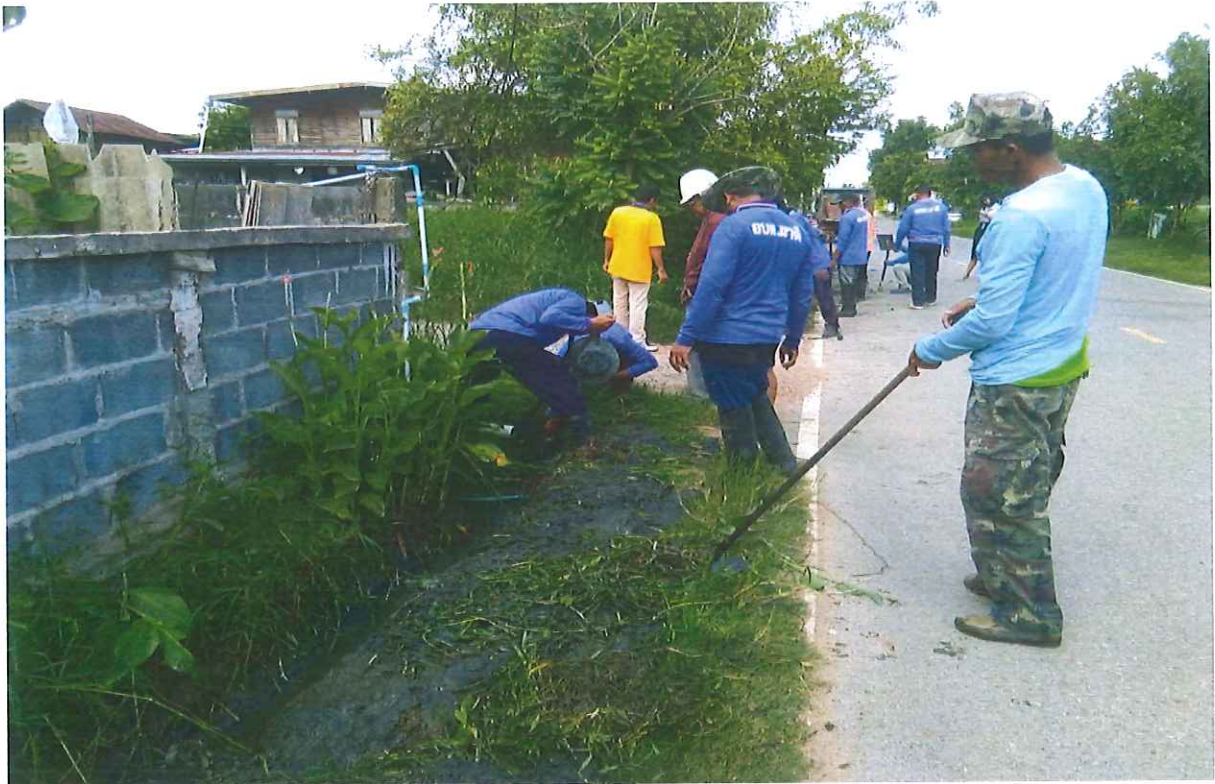
ภาพถ่ายขณะดำเนินการแก้ไขปัญหาคความเดือดร้อน ท่อระบายน้ำอุดตัน บริเวณหน้าบ้านนายสมโภชน์ ภูกระทาน ประชาชน บ้านโปแดง หมู่ที่ ๒ ตำบลนาดี อำเภอยางตลาด จังหวัดกาฬสินธุ์ ในวันที่ ๒๕ กันยายน ๒๕๖๓
