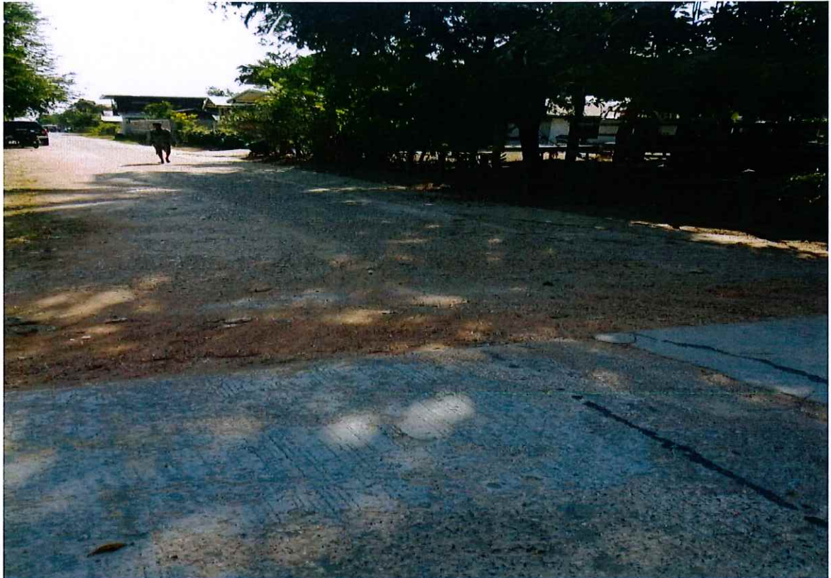
ภาพถ่ายสภาพปัจจุบัน ถนนคอนกรีตเสริมเหล็กบริเวณบ้าน นางคำบาง ภูขลิบม่วง บ้านปอแดง หมู่ที่ ๓
